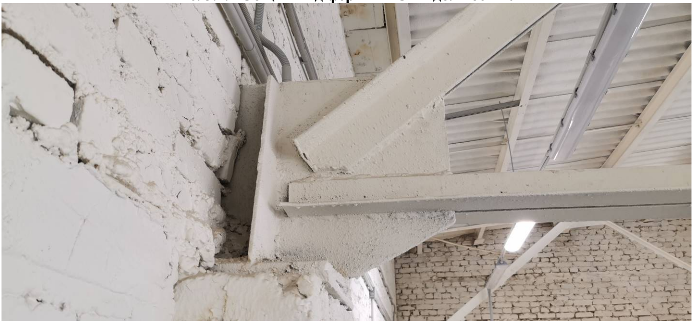
Рис. 3.2.2 Общий вид опирания нижнего пояса ферм типа ФС-1 на колонну вдоль оси Д
